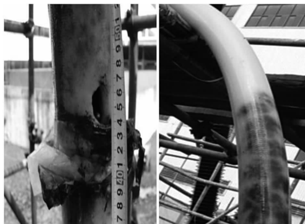
(a) 电缆故障点
